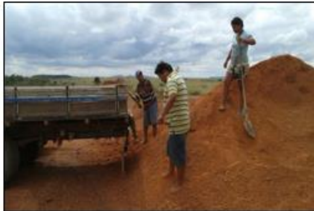
Figura 8 – Dia de mutirão para consertar a vicinal do polo 1 do Projeto de Assentamento Nova Amazônia – Boa Vista/Roraima
